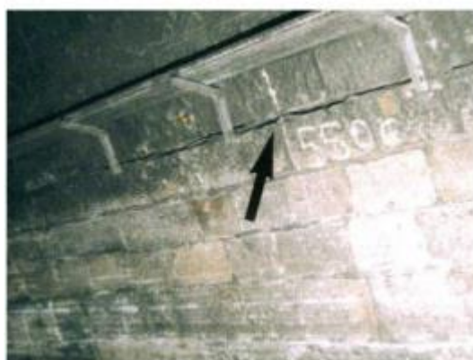
Figure IV-18 : Fissure longitudinale, le mortier est toujours présent sur une lèvre de la fissure (CETu, 2004)
