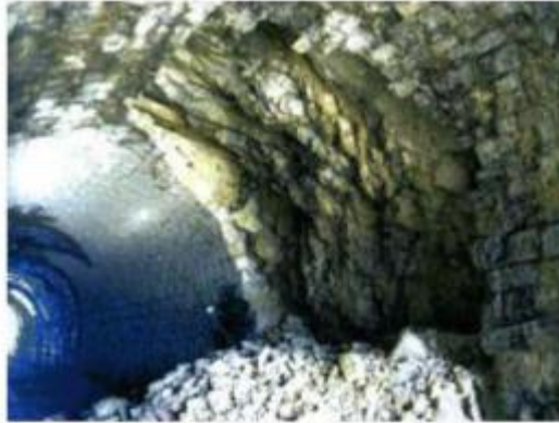
Figure IV-22 : Rupture partielle : La moitié de la voûte est tombée par écrasement du pignon (CETu, 2004)
