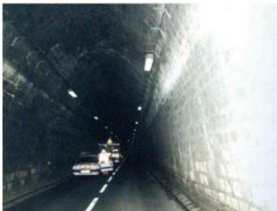
Figure IV-20 : Méplat dans un tunnel routier (CETu, 2004)
