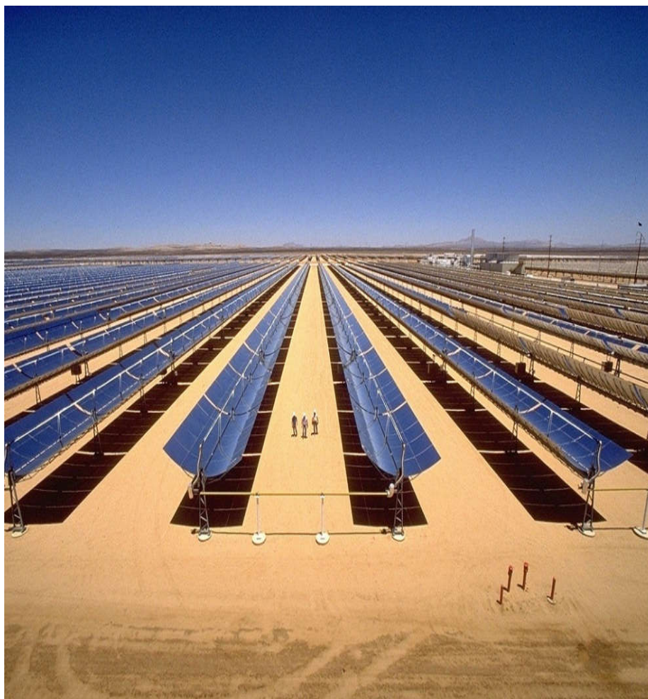
Fig. (I-9) : Centrale solaire thermique de type cylindro-parabolique
