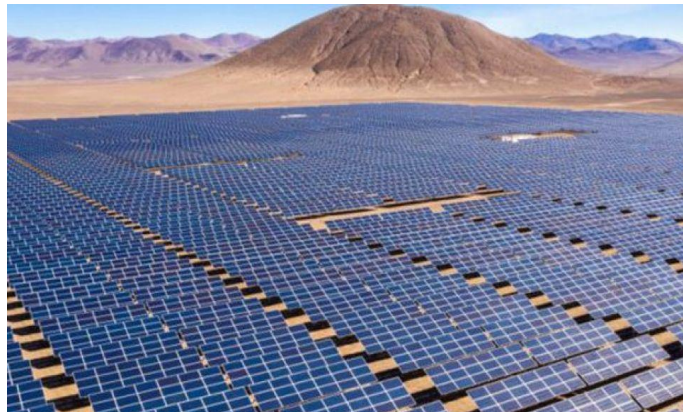
Figure I.10 : Parc d'énergie solaire photovoltaïque 150 MW à Béchar [33]
