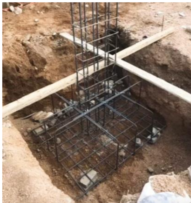
Figure 3.14 : Absence du béton de propreté
