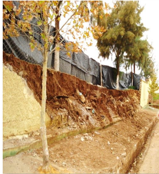
Figure 3.21. Basculement du mur [18]
