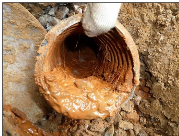
Figure 2.26. Colmatage de drain par ocre [7]
