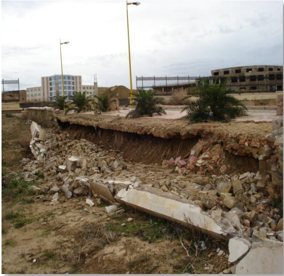
Figure 3.22. Rupture partielle du mur [18]
