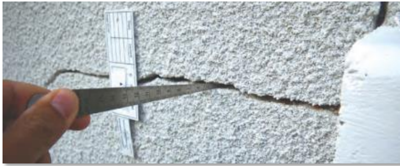
Figure 2.20. Fissures en escalier suite à un défaut de portance du sol [6]
