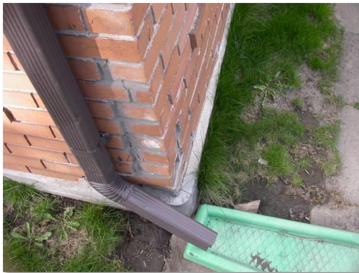
Figure 2.17. Fissures par sulfatation du béton [7]
